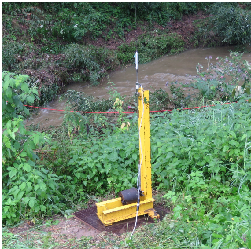
Obr. 12 – Ocelový rám s upevněným LVDT snímačem dráhy ISDL 80-KD-2405 ve vztažném bodu pod mostem pro měření svislého průhybu v bodu UZL
