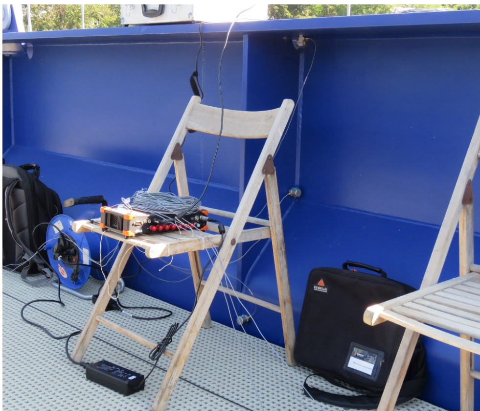
Obr. 5 – Pohled na měřicí ústřednu SIRIUS a levý hlavní nosník s uchycenými třemi snímači zrychlení 8344 ve středu rozpětí hlavního pole mostu
